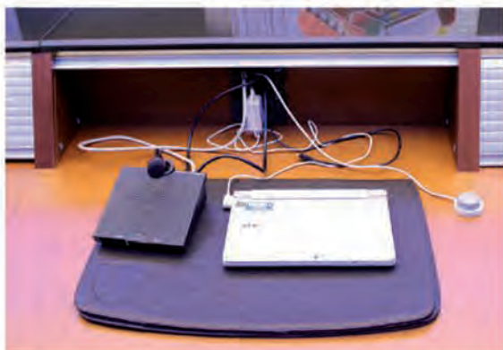
Una delle postazioni della sala, con PC, microfono e pulsante di prenotazione. Posizionati dietro un pannello di copertura, i cavi di collegamento con i trasmettitori.
